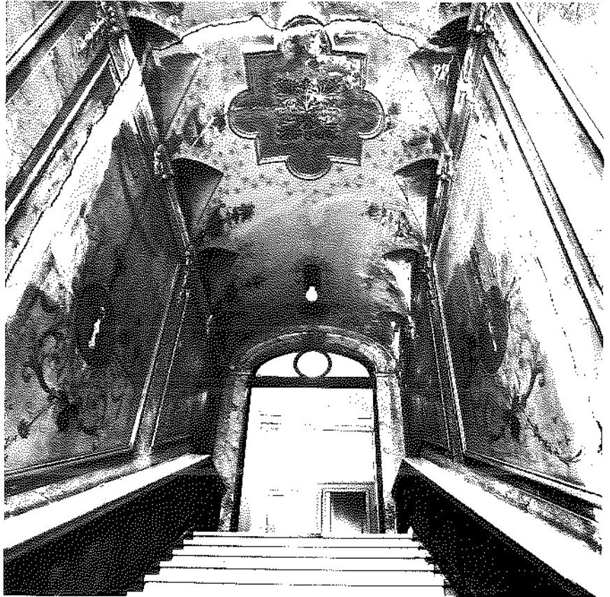
In diesem Zustand war der Treppenaufgang der Langenschen Villa, Haus „am Turm“, vor der Restaurierung 1991.
