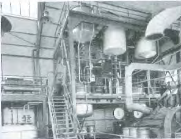
Produktionsanlage zur Herstellung von Harnstoffharz
