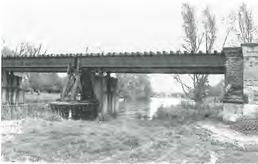
Die provisorisch wiederbergestellte Eisenbahnbrücke über die Agger, an der, bezahlt von den interessierten Nachbarkommunen Siegburg und Troisdorf, der im Kriege zerstörte Fußgängerweg befestigt wurde.
